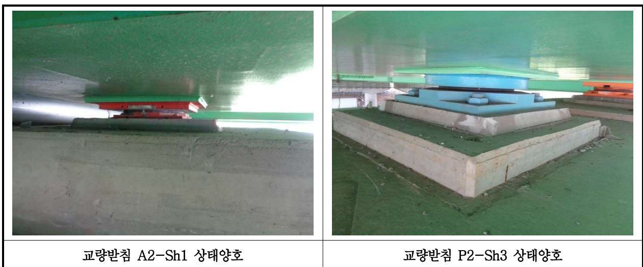
【사진 23.3.13】 교량받침 손상현황
